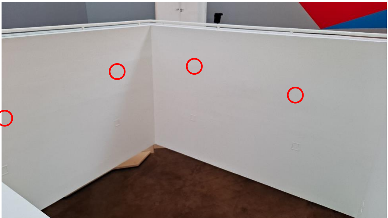
Ilustración 37. Balcón existente entre las galerías 302 y 202.
