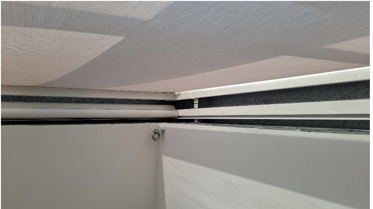
Ilustración 51. Vista general del anclaje, cortinas y guías
