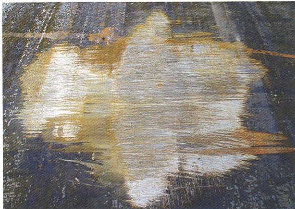
Fig.17. Daños por pérdida de la cascarilla superficial
