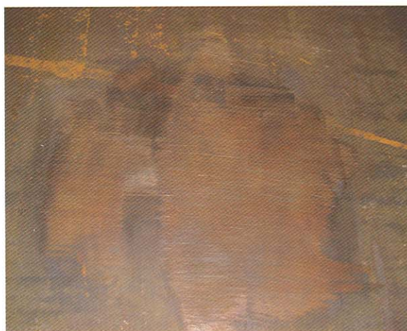
Fig.18. Corrosión de color anaranjado
