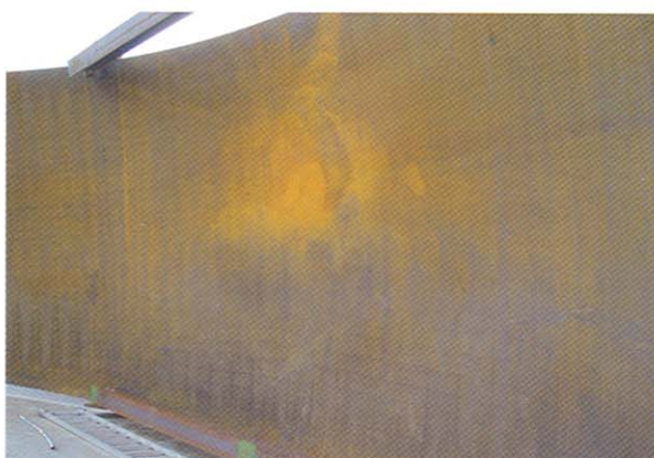
Figs. 15 y 16. Grandes mancha de óxido en el centro de dos de las planchas
