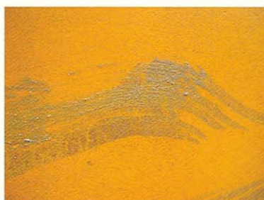
Fig. 21. Mancha de grasa
